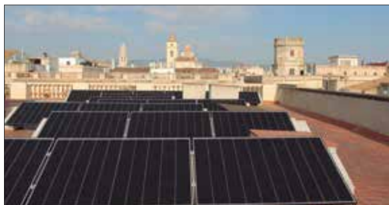
Plaques solars a la coberta de l'Ajuntament de Vilanova. ✖ AJUNTAMENT
