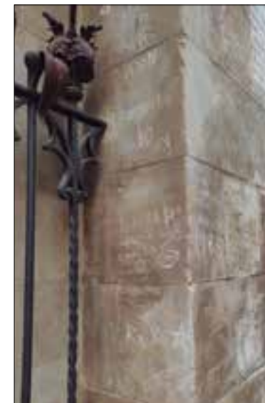
Les ratllades han malmès alguns carreus gòtics de la façana sud.
