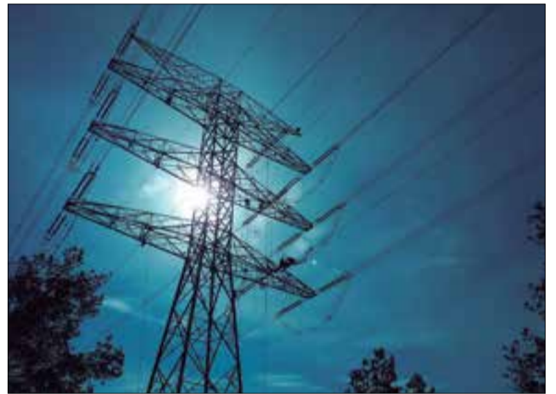
Torre d'alta tensió. ✱ ENDESA
