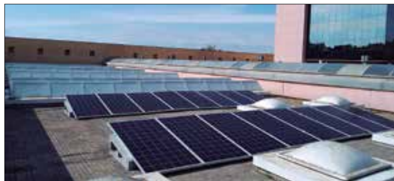
Plaques solars a la coberta d'un dels edificis de l'hospital. ✳ CONSORCI
