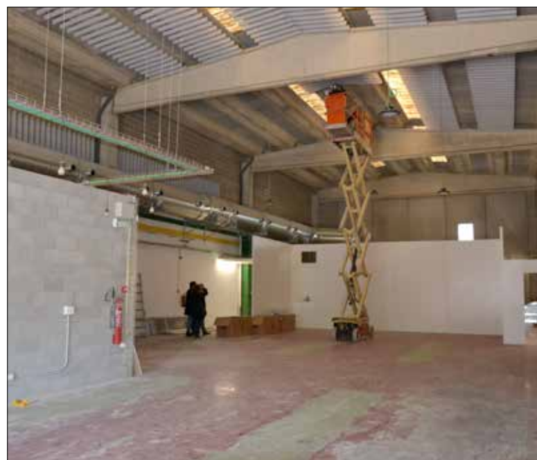
La nau està situada al carrer Marcel·lí Gener, prop de les pistes d'atletisme.
