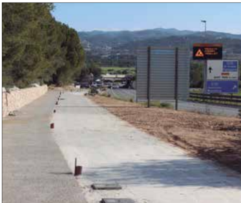
Les obres, en el darrer tram de la seva execució. ✦ LA FURA
