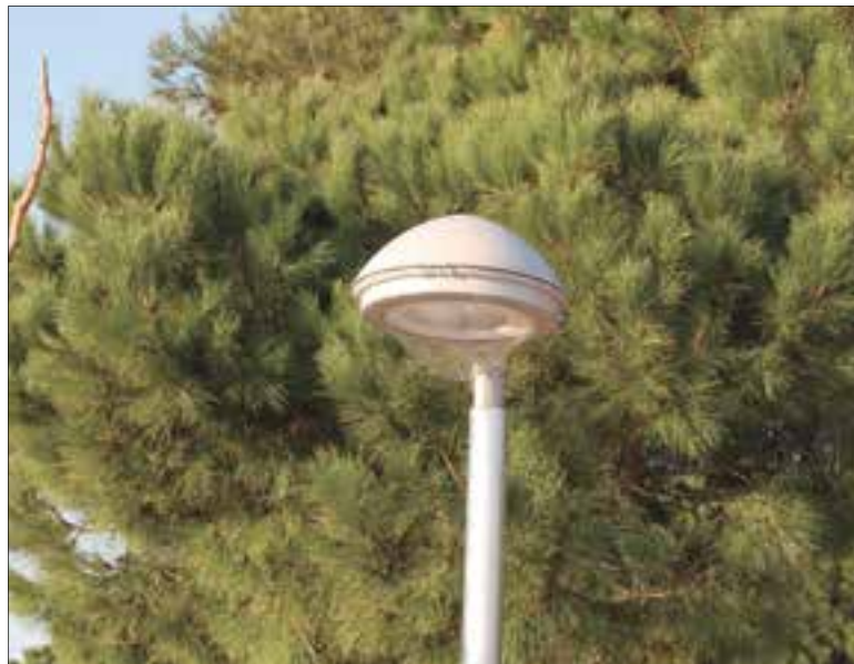
Es preveu que en un termini de dos anys es renovi tot l'enllumenat públic de la ciutat ✦ AJUNTAMENT
