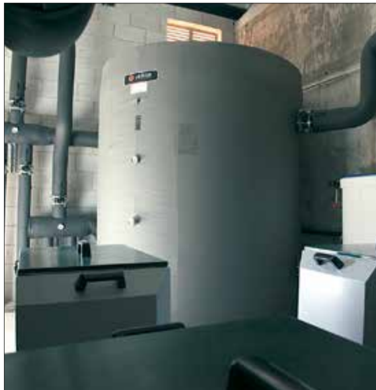
Caldera de biomassa a Balsareny. ✖ DIPUTACIÓ DE BARCELONA
