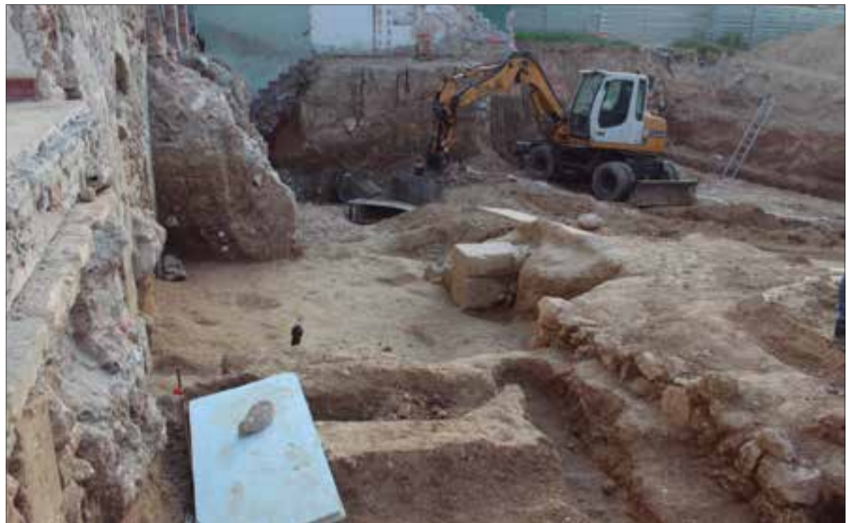
Els treballs d'excavació són previs a la construcció de l'edifici amb què s'ampliarà el Vinseum. ✱ LA FURA
