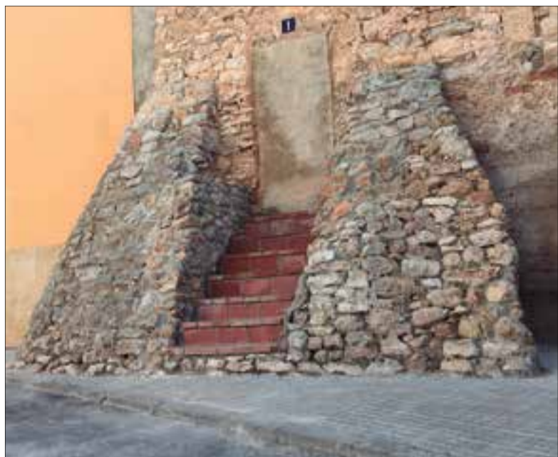
Els arranjaments s'han fet sobre els murs originals de l'antic castell. AJUNTAMENT
