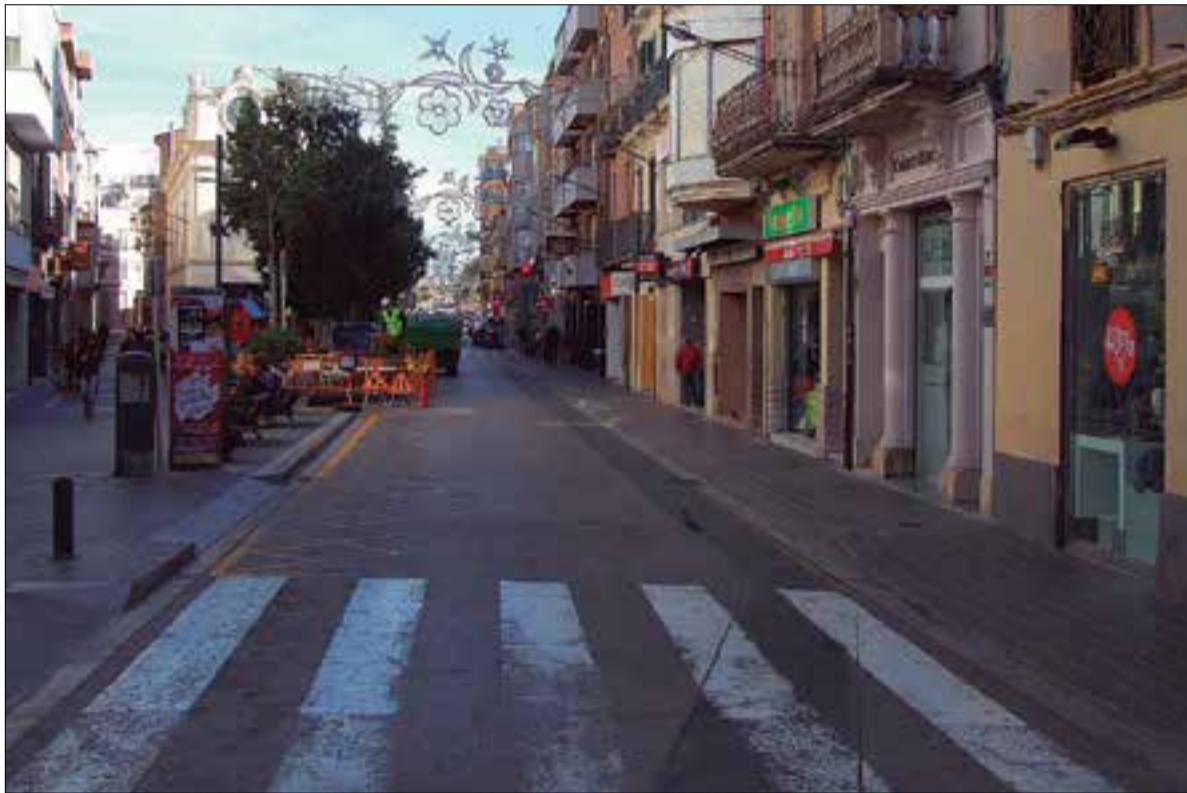
El carrer Dr. Robert, en obres per la instal·lació de fibra òptica. ✱ AJUNTAMENT
