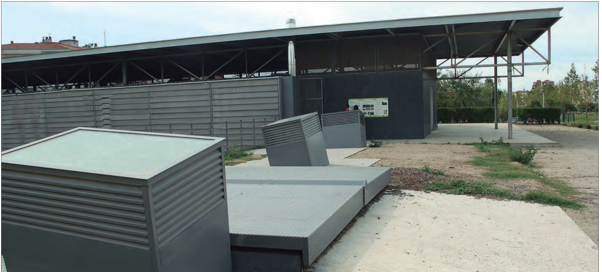
La caldera annexa a l'Arxiu Comarcal de l'Alt Penedès subministra aigua per a calefacció a quatre equipaments públics de Vilafranca (Arxiu Comarcal, Escola Dolors Piera, Llar d'Infants El Parquet i Servei Educatiu CRP de l'Alt Penedès), ubicats a l'avinguda d'Europa, a la Girada.
