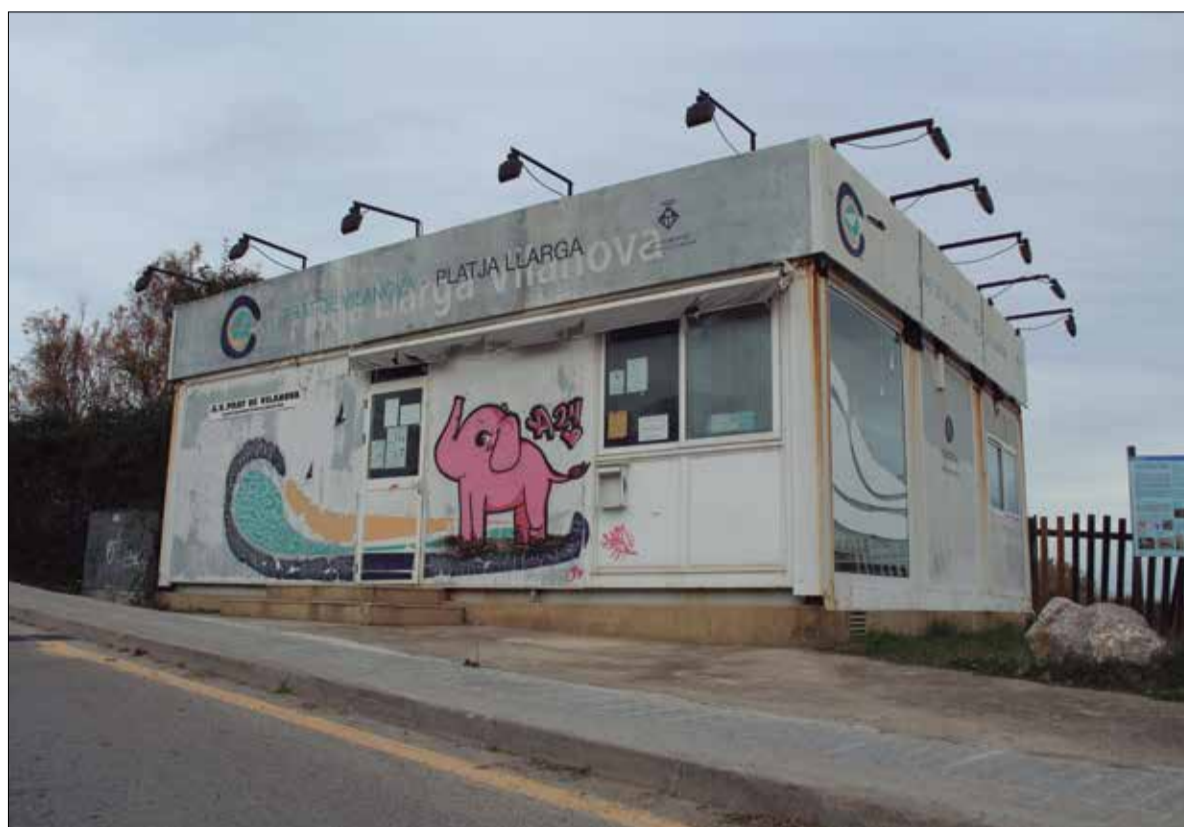
La caseta no es pot fer servir des del gener del 2021 a causa del seu mal estat. ✦ LA FURA
