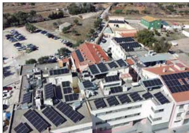
S'han instal·lat mòduls solars de 99 kw.
