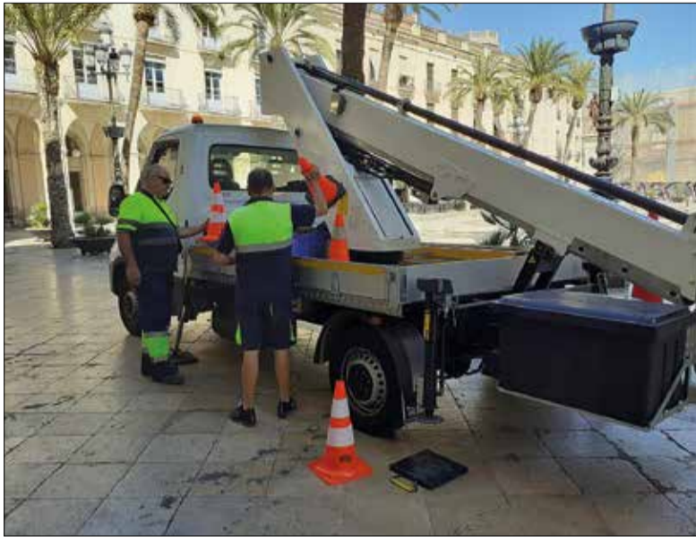
Vilanova unifica el manteniment de la xarxa d'enllumenat.
