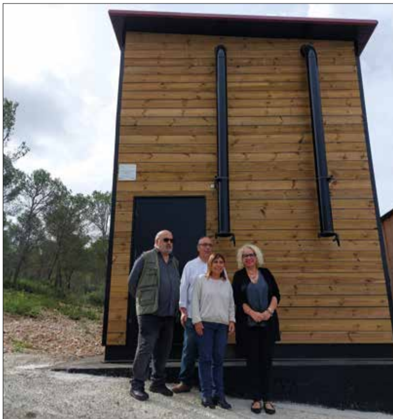
La caldera de biomassa de Canyelles. ✦ AJUNTAMENT / CONSELL COMARCAL
