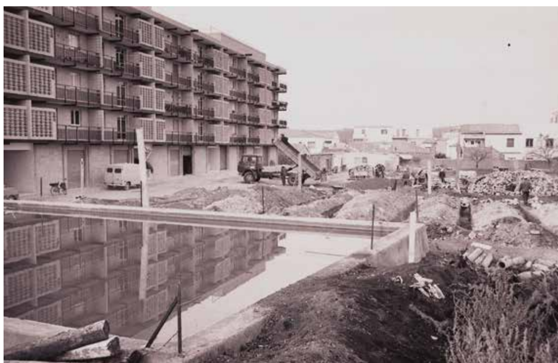
Construcció dels Pisos Planas. Anys 60. ✦ ARXIU COMARCAL DEL BAIX PENEDÈS / JAUME DOMINGO MULET
