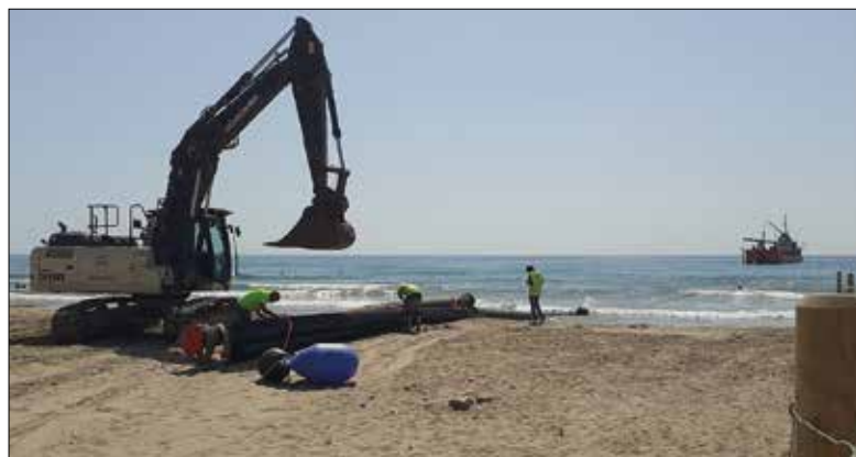
La sorra arriba a través d'una canonada des de la draga. ✳ AJUNTAMENT
