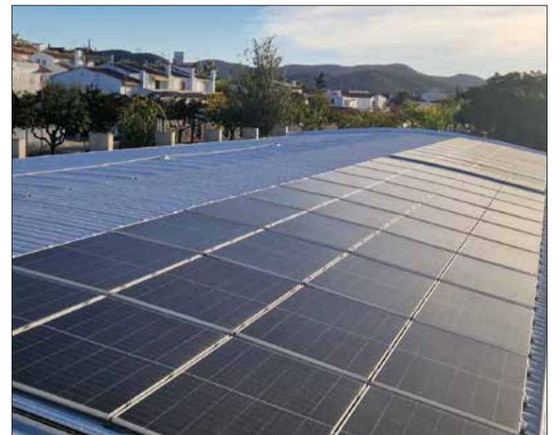
Plaques solars instal·lades a l'Espai Blau de Ribes. ✖ LA FURA
