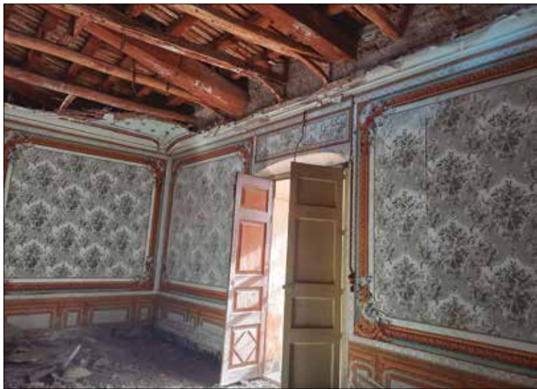
Es tracta d'una afectació estètica i no estructural. ✱ CEDIDA
