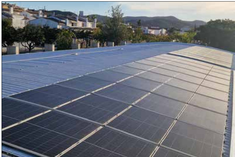
Plaques fotovoltaïques de l'Espai Blau, a Sant Pere de Ribes. ✱ LA FURA
