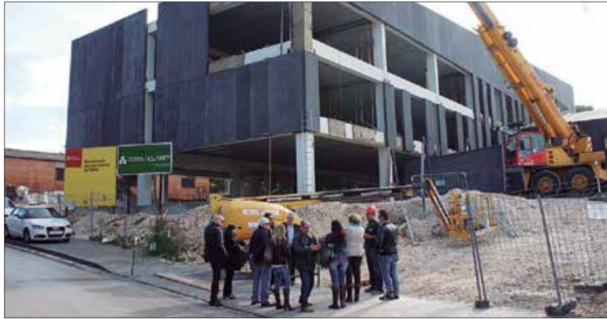
Visita que es va fer dimarts a les obres del nou edifici de l'institut La Talaia. ✱ FIRMA FOTO
