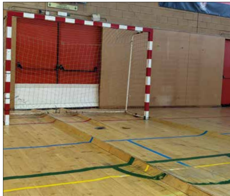
L'aigua que ha entrat al pavelló ha malmès el parquet de la pista. ✳ LA FURA
