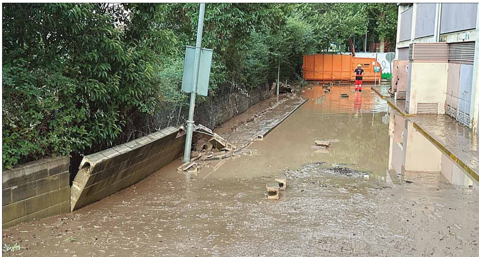
El mur lateral de l'hospital va caure a causa de la força de l'aigua i va inundar el soterrani del centre. ✪ AJUNTAMENT
