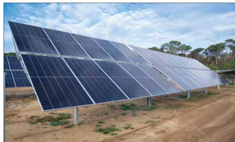
Plaques fotovoltaïques en un parc solar de Vidreres (La Selva). ✱ ACN
