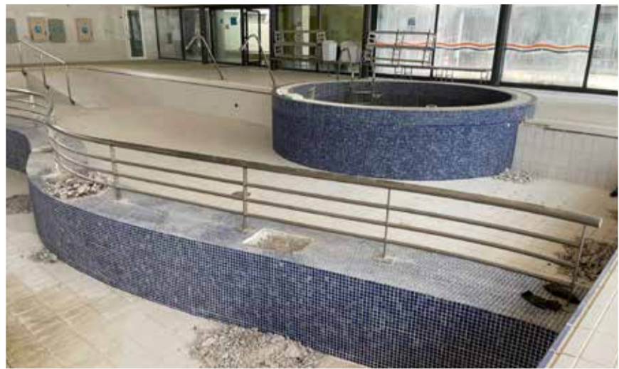
La piscina gran del Complex Aquàtic malmesa per la dana. ✳ AJUNTAMENT
