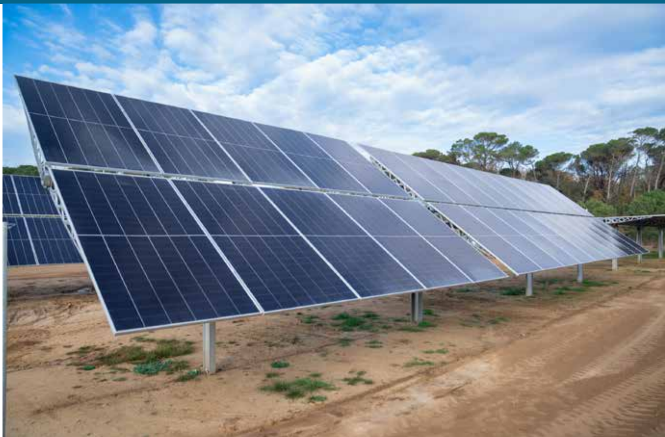
Grans empreses han presentat diversos projectes de macroinstal·lacions fotovoltaïques a diferents municipis de la vegueria. ✪ ACN
