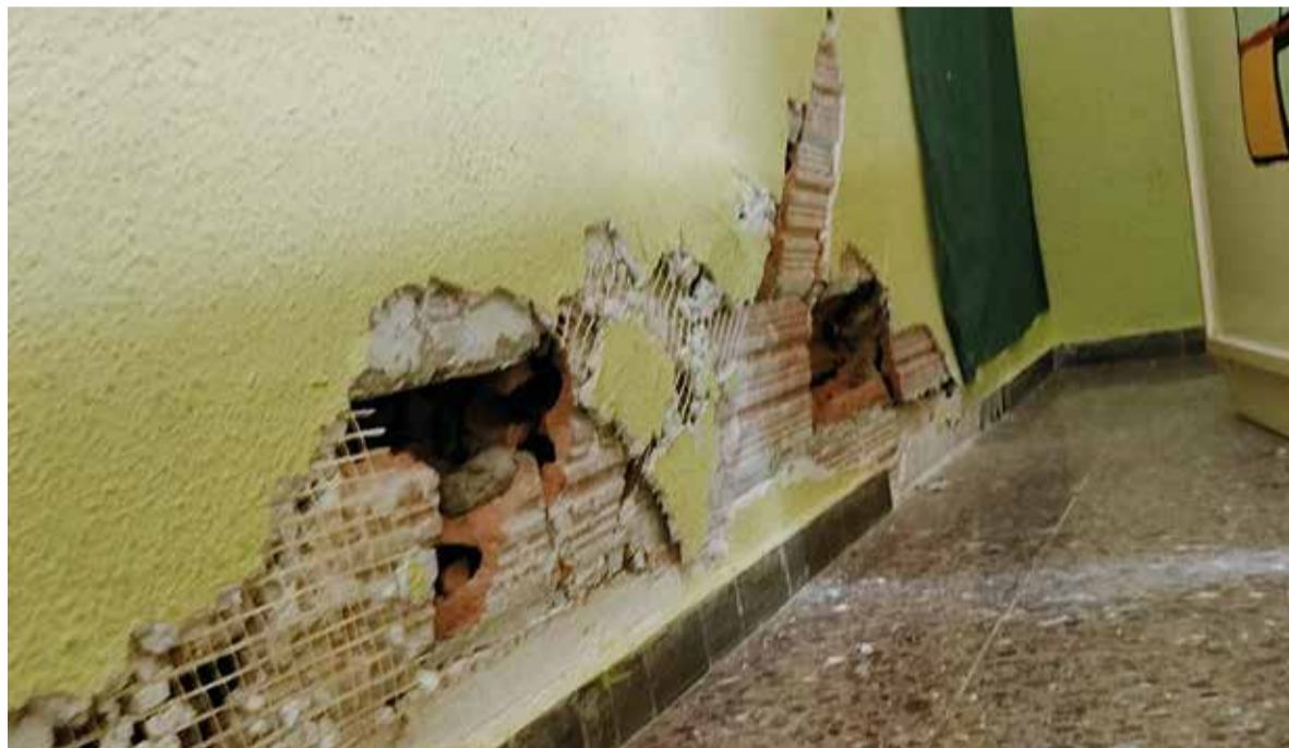
Una de les esquerdes que es poden observar en un dels blocs tancats. ✱ CEDIDA
